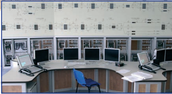
Central sous-station de LGV
