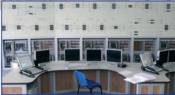
Central sous-station de LGV
