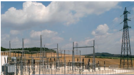
Sous-station de LGV
